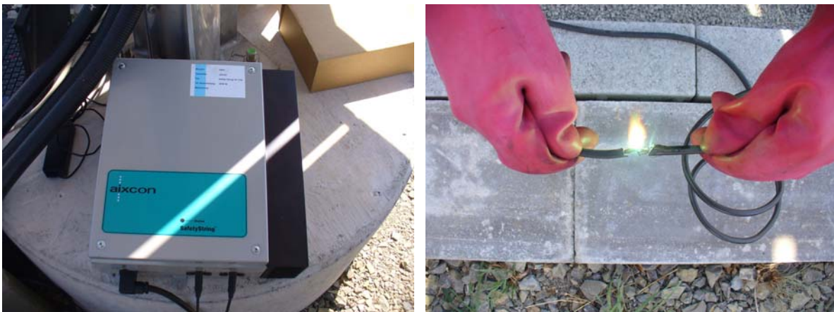
Bild 4: Eingesetzter Wechselrichter (links), gezogener Lichtbogen im Leerlauf des Solargenerators (rechts)
