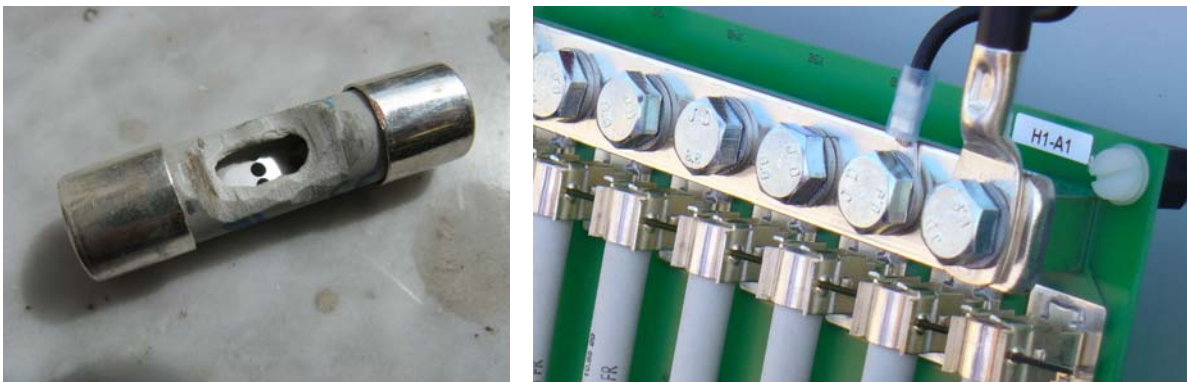
Abbildung 10: PV-Sicherung mit freigelegtem perforierten Schmelzleiter (links). Einseitiger, unvorteilhafter Anschluss der Gleichstromhauptleitung an der Sammelschiene (rechts)
